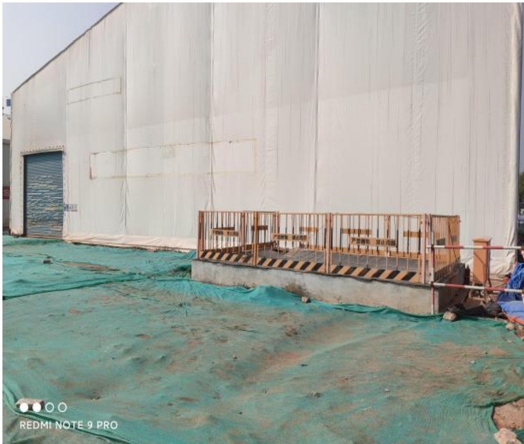
图 3.5-12 筛上物冲洗后废水三级沉淀池收集
