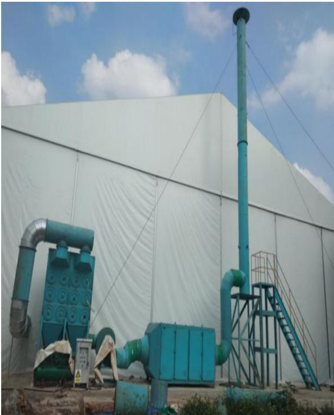
图 3.5-1 处置大棚尾气处理
